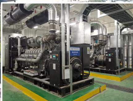
10*1600kW 0.4kV 50Hz 开放式
