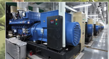
112*2000kW 10.5kV 50Hz Open Type
