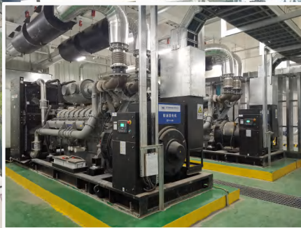
10*1600kW 0.4kV 50Hz Open Type
