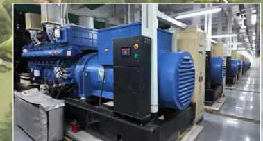
112*2000kW 10.5kV 50Hz Open Type
